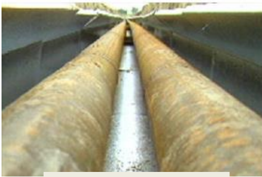
H. S. Ligne de transport
